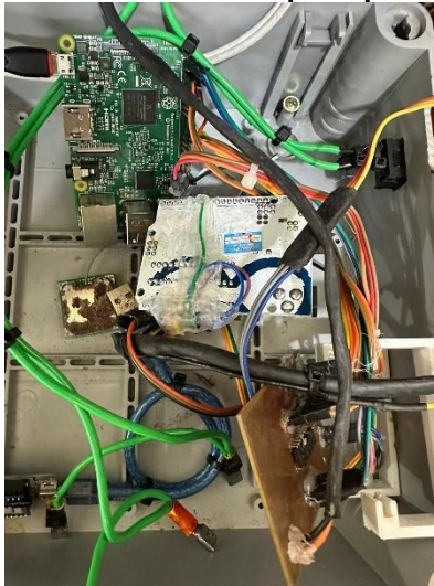
Figura 5 - Estrutura instalada em campo experimental danificada.
